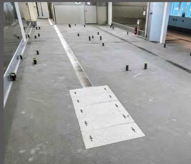
グリーストラップ廻り ステンレス竊板、ピット枠、グレーチング
