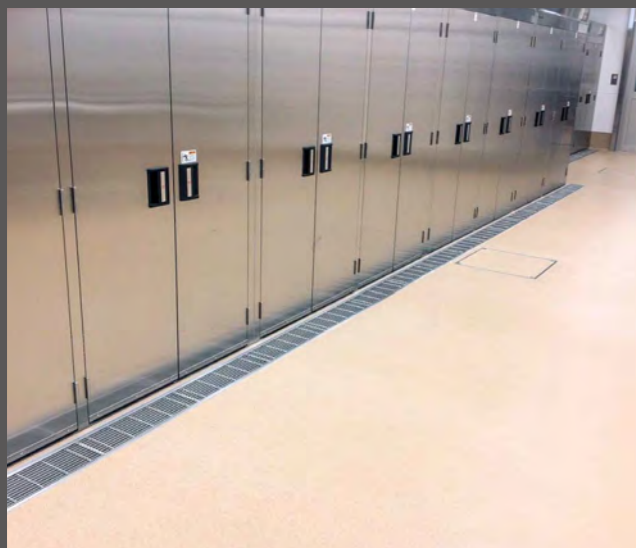
消毒保管機廻り グレーチング、ピット枠
