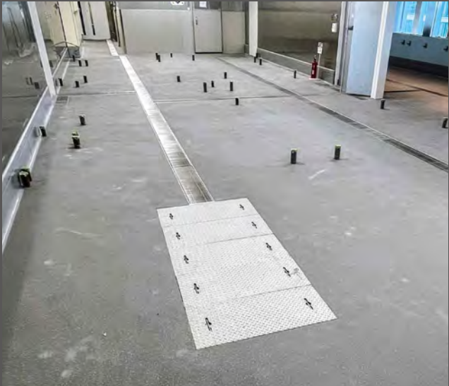
グリーストラップ廻り ステンレス竈板、ピット枠、グレーチング
