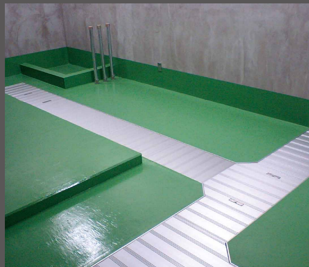
ポンプ場 発電機室 アルミ製スリット付中空パネル JP-WAVC-1
