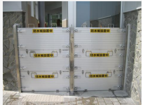
脱着式防水板 設置時
