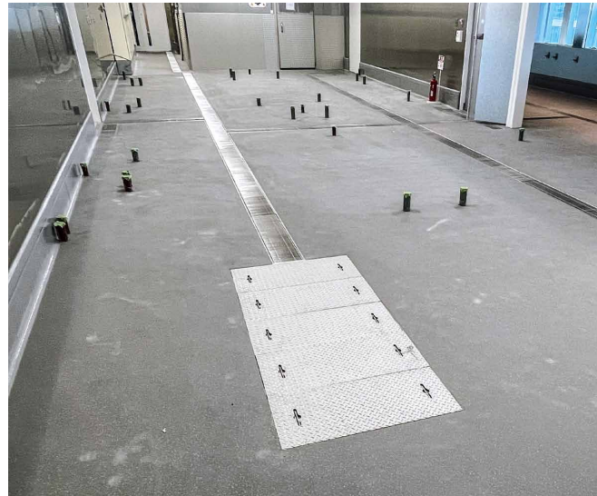
グリーストラップ廻り ステンレス竈板、ピット枠、グレーチング
