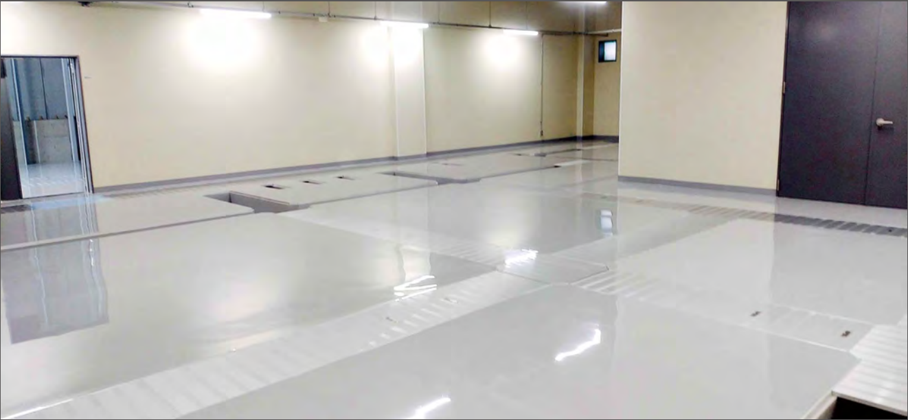
新幹線配電盤室 アルミ製スリット付中空パネル
