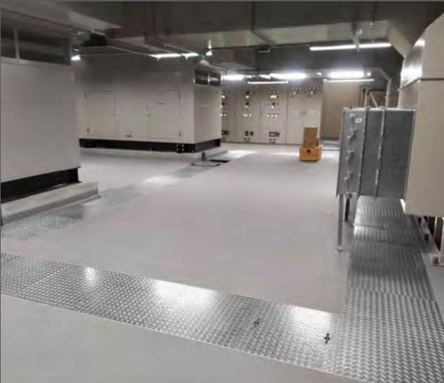
電気室 縞鋼板
